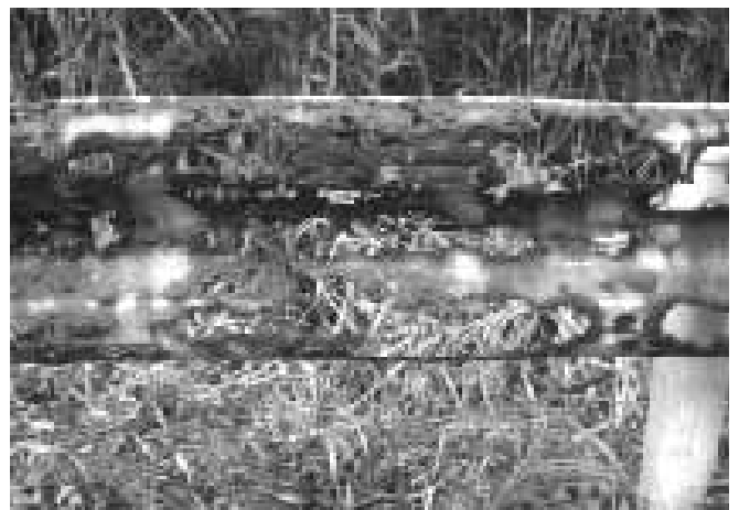
写真2. 阿嘉島中央部の大岳（160.7m）周辺で見られた塩害で腐食したガードレール
